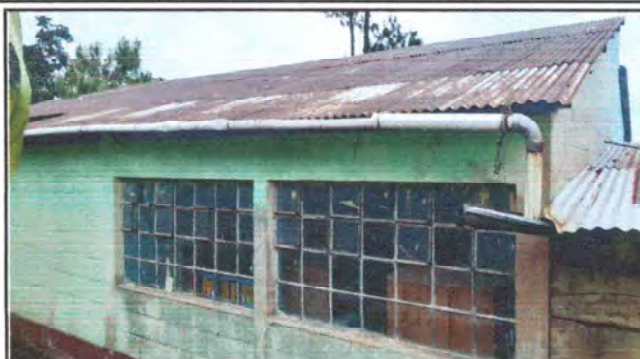
Foto 2: sustitucion de cubierta de lamina deteriorada
